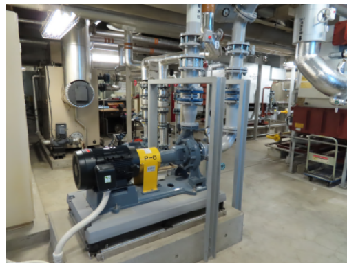
冷却水ポンプ
