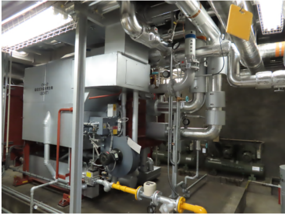
排熱温水投入型ガス吸収式冷温水機
