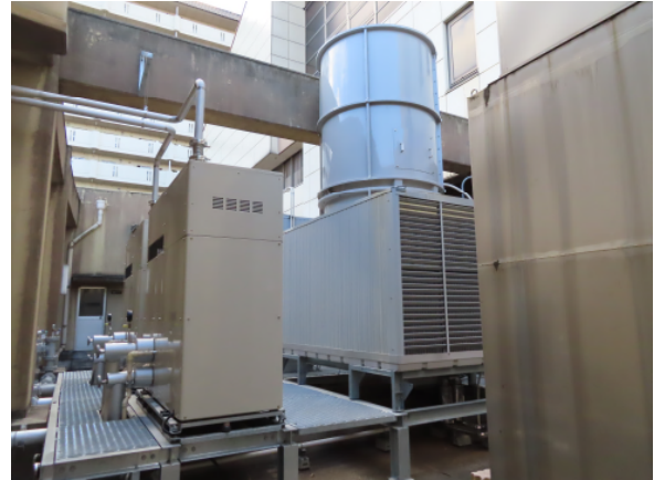
吐出ダクト付冷却塔
